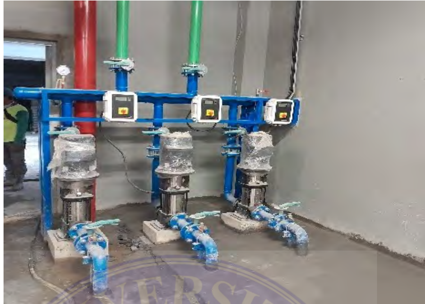
Gambar 3. Pipa GIP untuk Pipa Transfer (Rumah Sakit Regina Maris 2023)
