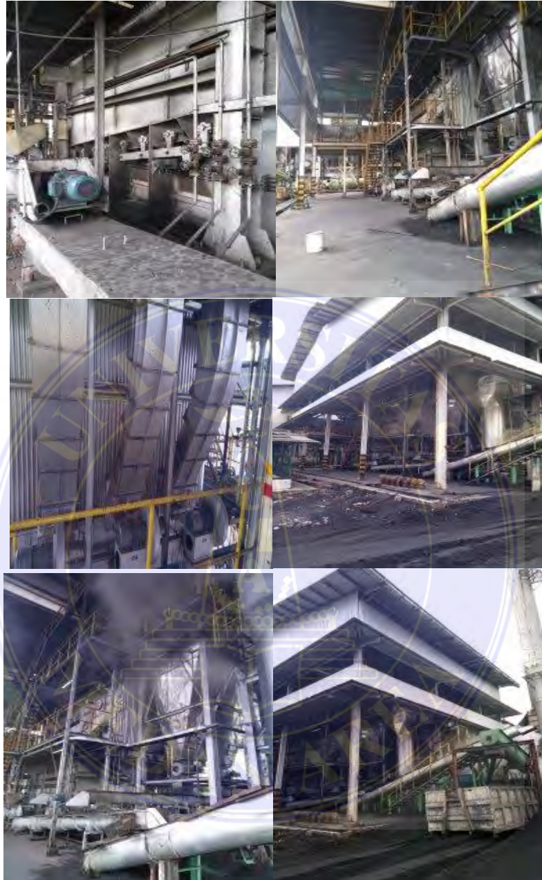
Gambar 3.2 boiler di pabrik PT. Perkebunan Lembah Bhakti, Agro Lestari Aceh Singkil.
