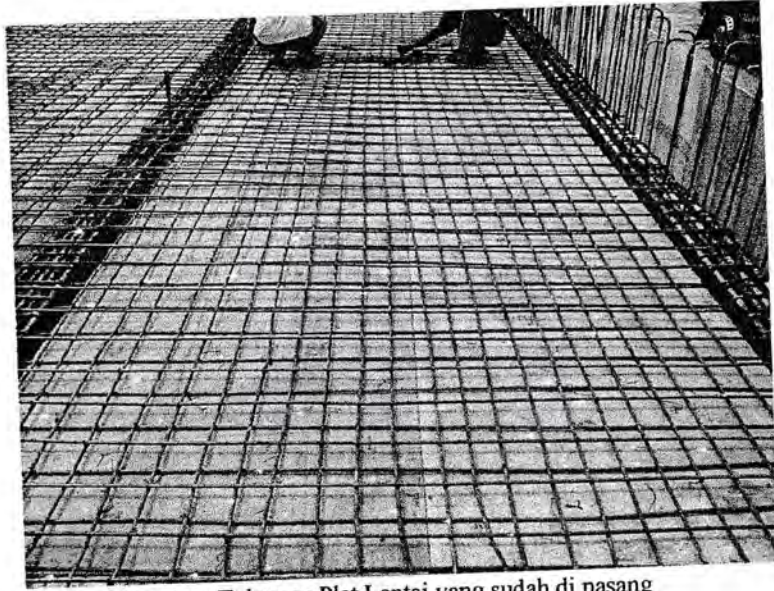
Gambar. Tulangan Plat Lantai yang sudah di pasang Lokasi : Jalan Gatot Subroto , Medan
