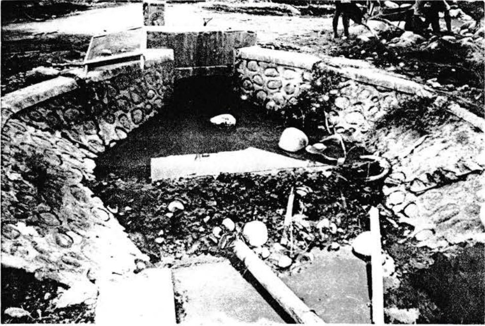
Gambar I Sebelum di Rehab
