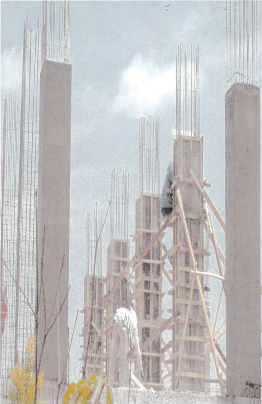
Gambar 9: Bagian Kolom yang Sudah Mengering.
