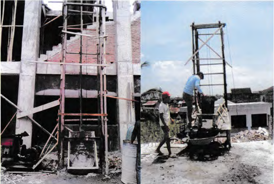
Gambar 2.3.1. Cran (lift barang)
