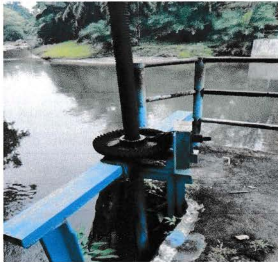
Gambar 3. Bendungan ; Pintu air Irigasi Sawah
