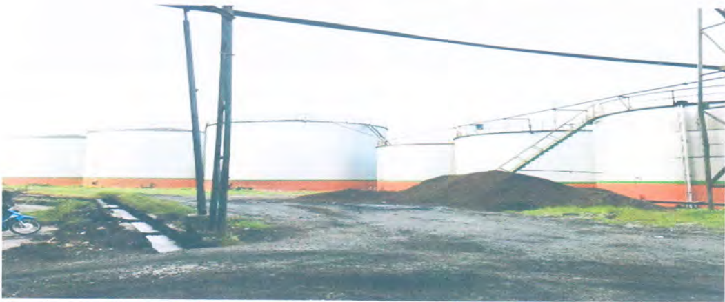
Gambar 16. Storage Tank (sumber = Tim PKL di Kebun PTPN IV Unit Tinjowan 2019).
