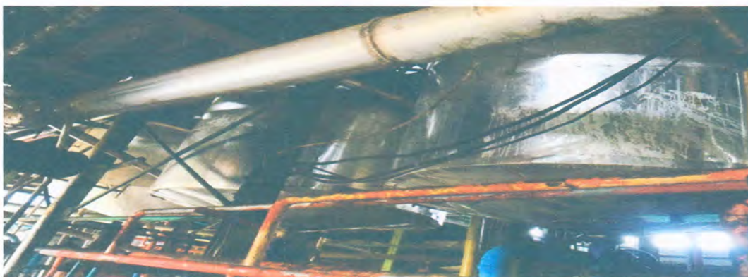
Gambar 15. Sludge Tank (sumber = Tim PKL di Kebun PTPN IV Unit Tinjowan 2019).
