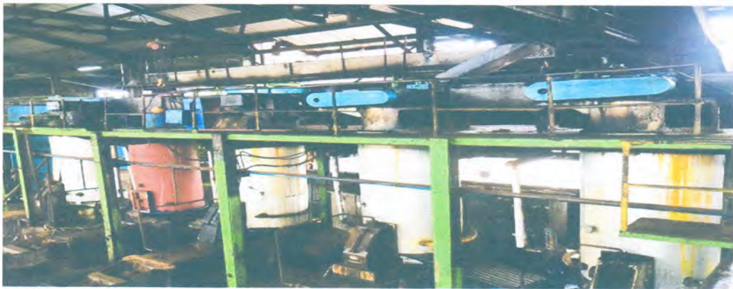
Gambar 7. Digester (sumber = Tim PKL di Kebun PTPN IV Unit Tinjowan 2019).
