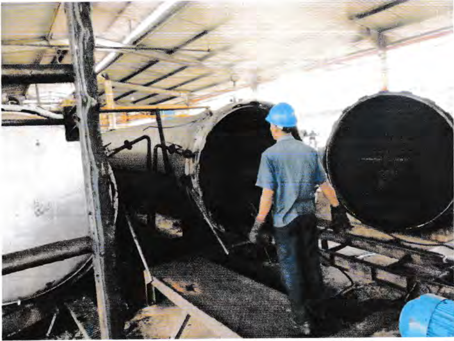
Gambar 14 : Pabrik Pengolahan Kelapa Sawit - Horizontal Sterilizer
