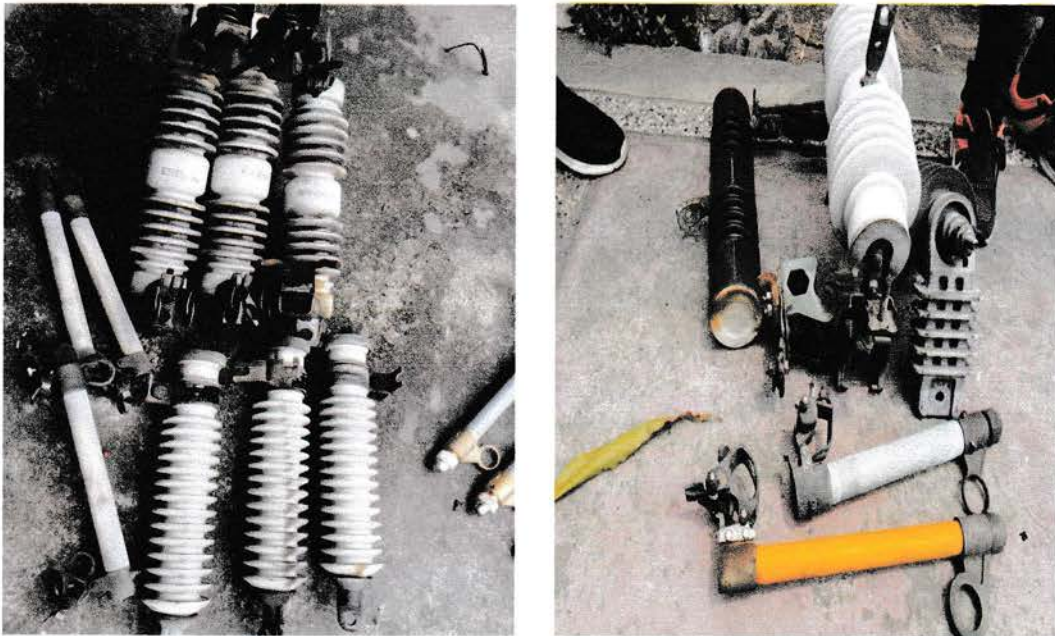
Gambar 4.1 FCO dan Lighting Arrester yang rusak
