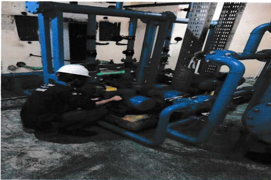
Gambar 3.9 : Pipa Transmisi dan Distribusi di GMP
