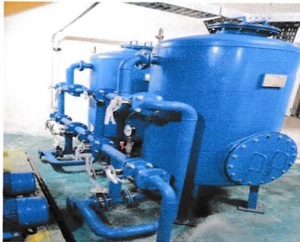
Gambar 4.1 : Pressure Filter di GMP
