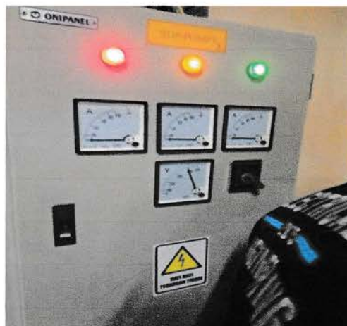
Gambar 3.2 : Panel Pompa di GMP
