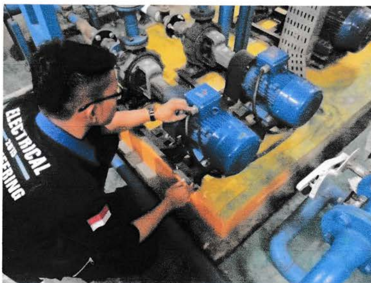
Gambar 3.6 : Pompa Air di GMP
