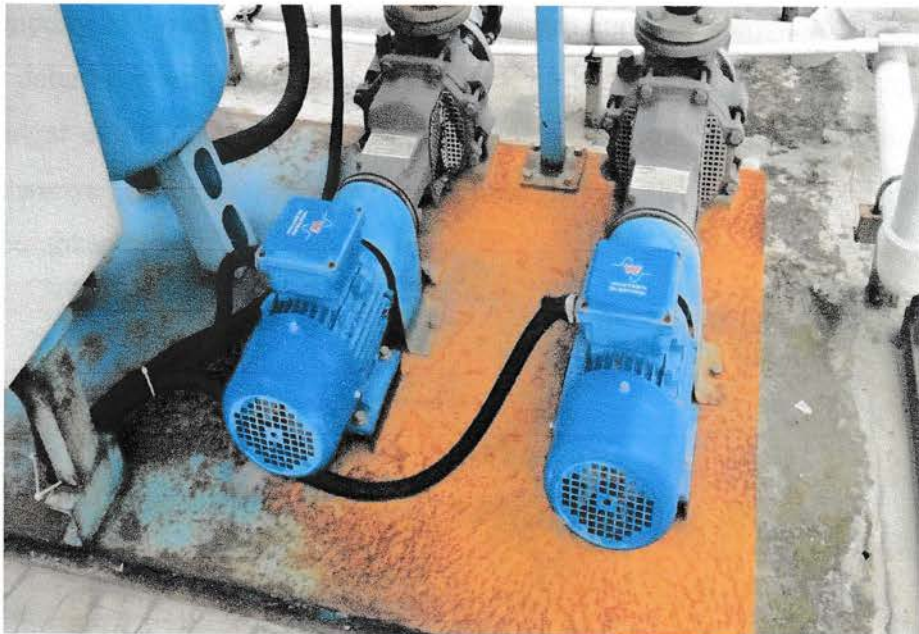
Gambar 3.7 : Booster Pump di GMP
