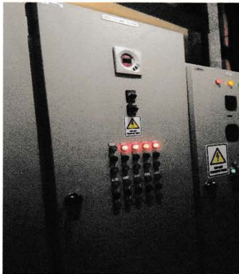
Gambar 3.2 : Panel Kapasitor Bank DI GMP
