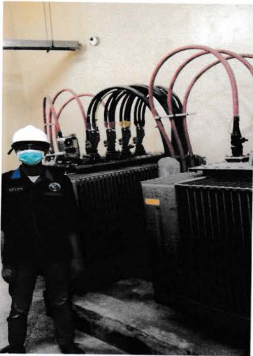
Gambar (f) : Trafo 800 KV a GMP
