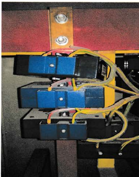
Gambar 3.11: Bentuk Current Transformer
