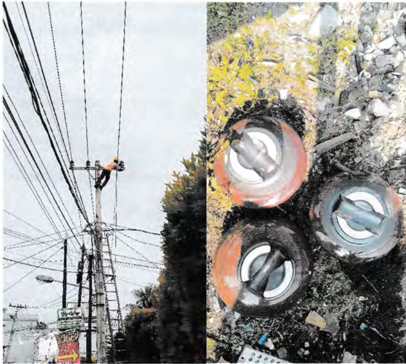
Gambar 4.1 Gangguan Akibat Isolator Flash Over (Sumber : Penulis, 2019)
