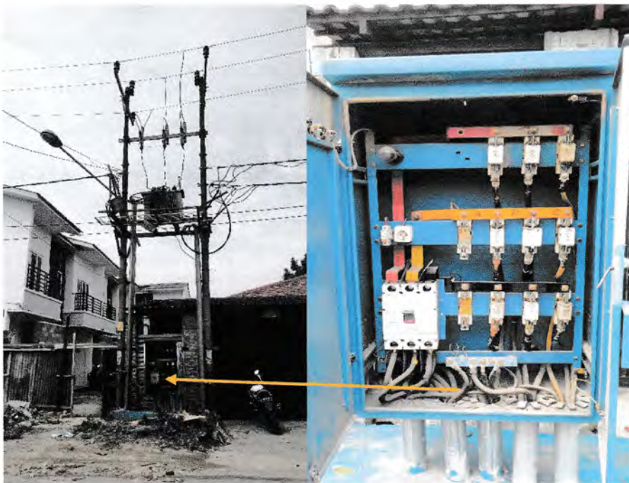
Gambar 3.8 Gardu Tiang Tipe Portal dan Midel Panel (Sumber : Penulis, 2019)
