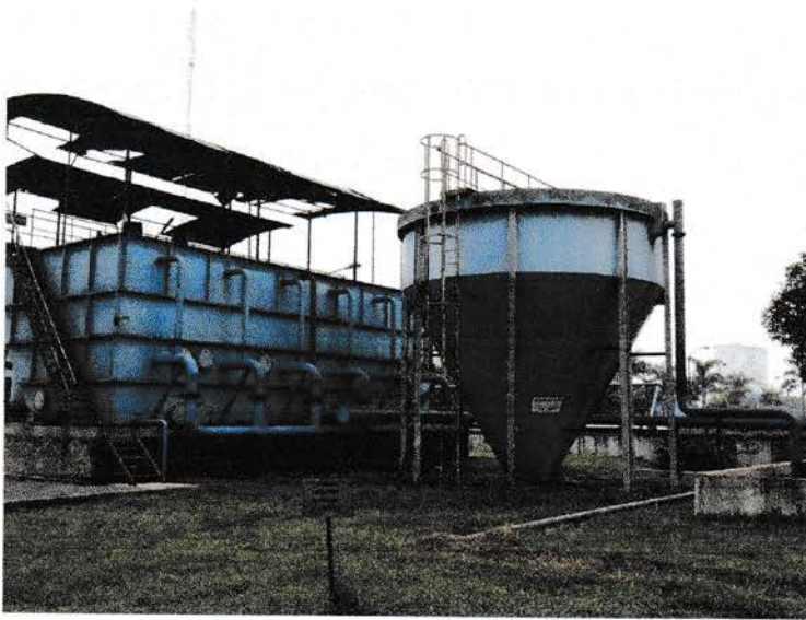
Gambar 3.31 Stasiun Pengolahan Air (Water Treatment)
