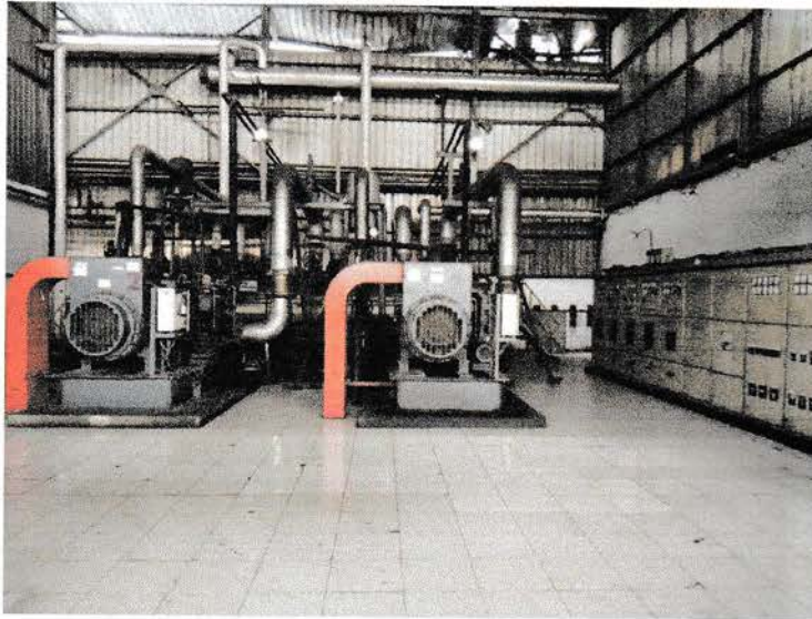
Gambar 3.30 Stasiun Kamar Mesin
