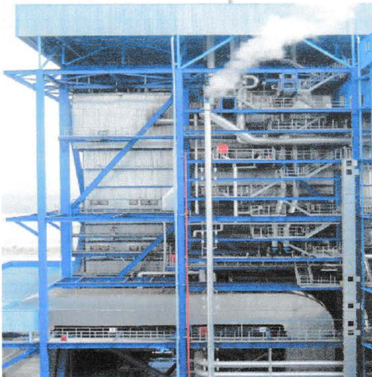
Gambar III. 3 : Boiler PLTU (Pembangkit Listrik Tenaga Uap)
