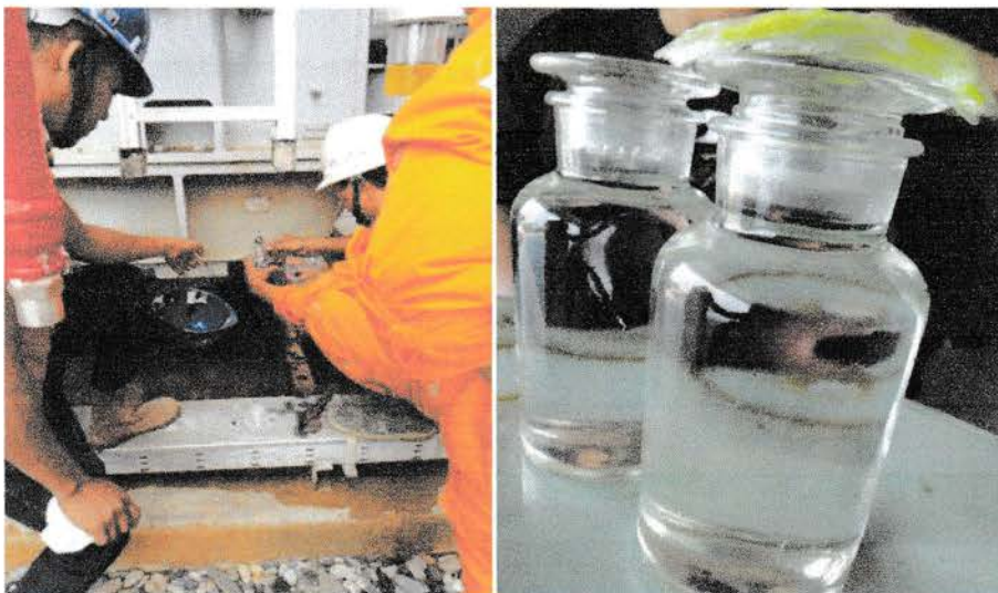
Gambar III. 11. Gambar Minyak Oli Trafo
