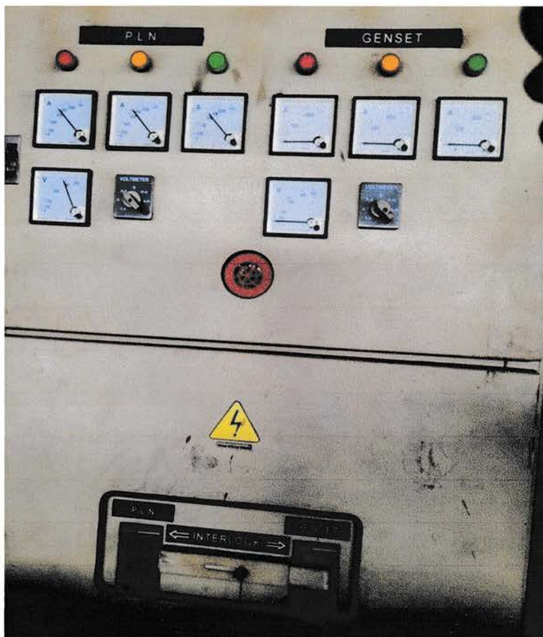
Gambar 3.10 Mesin Panel Tegangan Listrik
