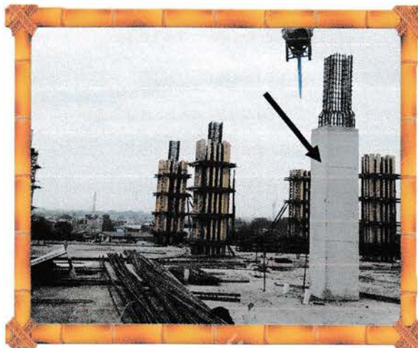
Gambar III. 24 Kondisi Kolom setelah dibuka 21 hari
