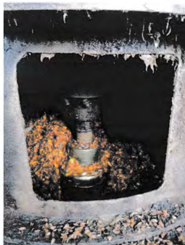
Gambar 3.14 Bagian dalam digester
