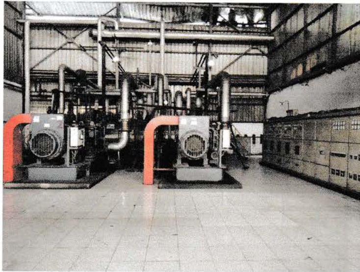
Gambar 3.30 Stasiun Kamar Mesin
