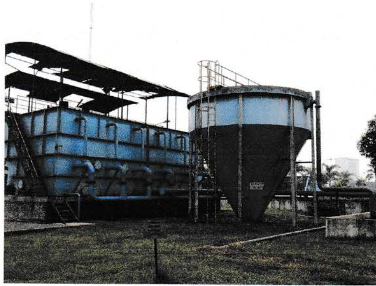
Gambar 3.31 Stasiun Pengolahan Air (Water Treatment)
