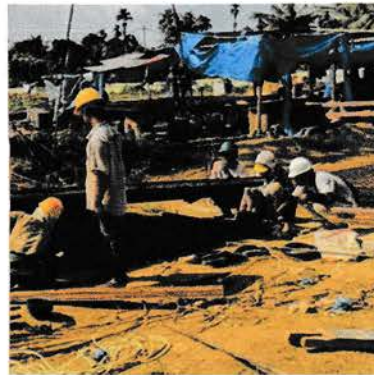
Gambar 4.77 Beberapa Pekerja tidak Menggunakan APD Lengkap
