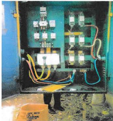
Gbr 3.6 Box Papan Hubung Bagi / LVC
