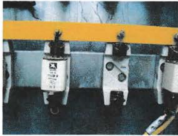
Gbr 3.7 Busbar Sebagai tempat dudukan NT/NH fuse dan Kabel
