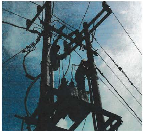
HAR GARDU KB-15 (25kVA 3Ø) ALAMAT : PADANG MANINJAU KEC.NA.IX-X
