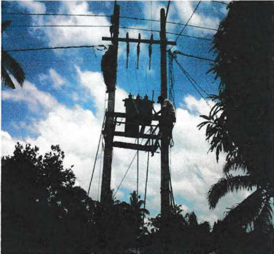
HAR GARDU MB-08 ALAMAT : DUSUN PANDUMAAN KEC.MARBAU
