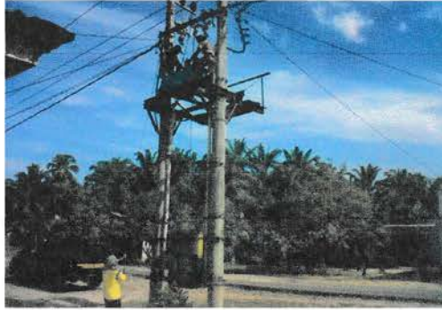
HAR GARDU MB-20 (100kVA 3Ø) ALAMAT : PULO BARGOT KEC.MARBAU
