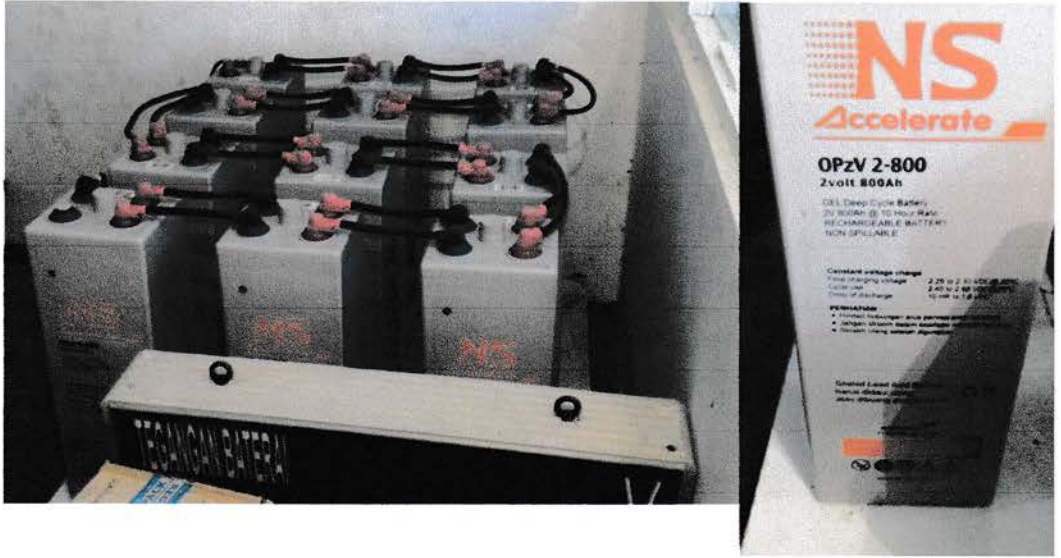
Baterai Penyimpan Daya
