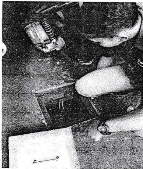
Gambar 4.4.2(b): Pemeriksaan Konduktor pada Bak Kontrol
