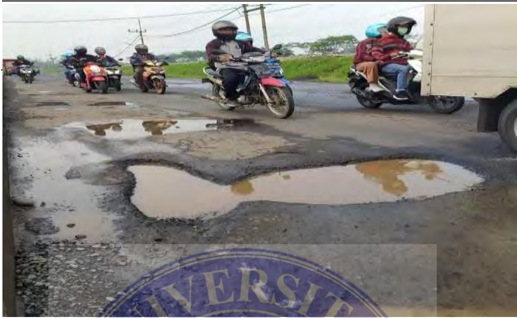
Gambar 2.3.9 Jalan berlubang ( Potholes )
