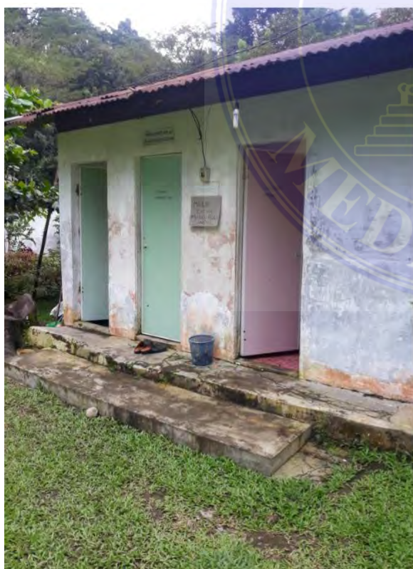
Gambar 15. Kondisi Kamar mandi
