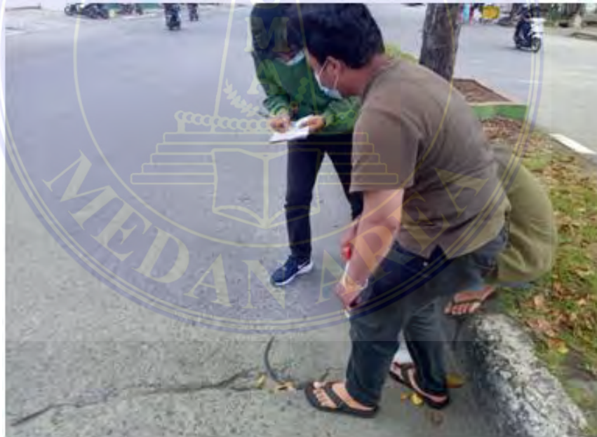
Pengukuran Kerusakan Jalan ( Retak)
