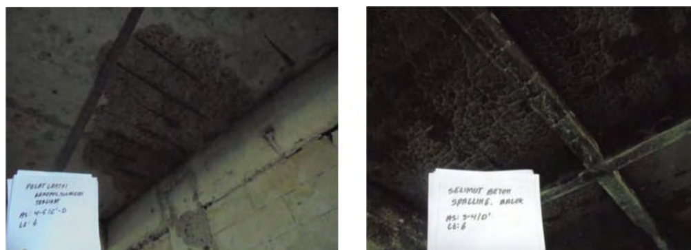
Gambar 3.3 Visual Area Struktur Lt. 6 Terdampak Kebakaran Sumber : Dokumentasi Survey Lapangan
