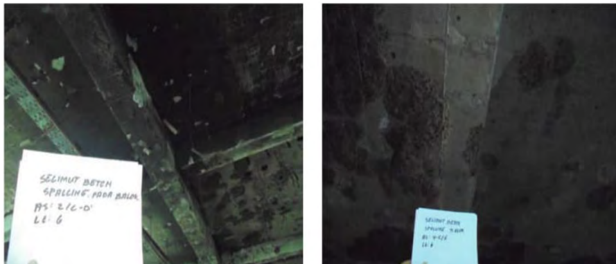
Gambar 3.12 Kerusakan Tipikal Pada Balok Lt.6 Sumber: Pihak Pengelola The Reiz Condo Medan
