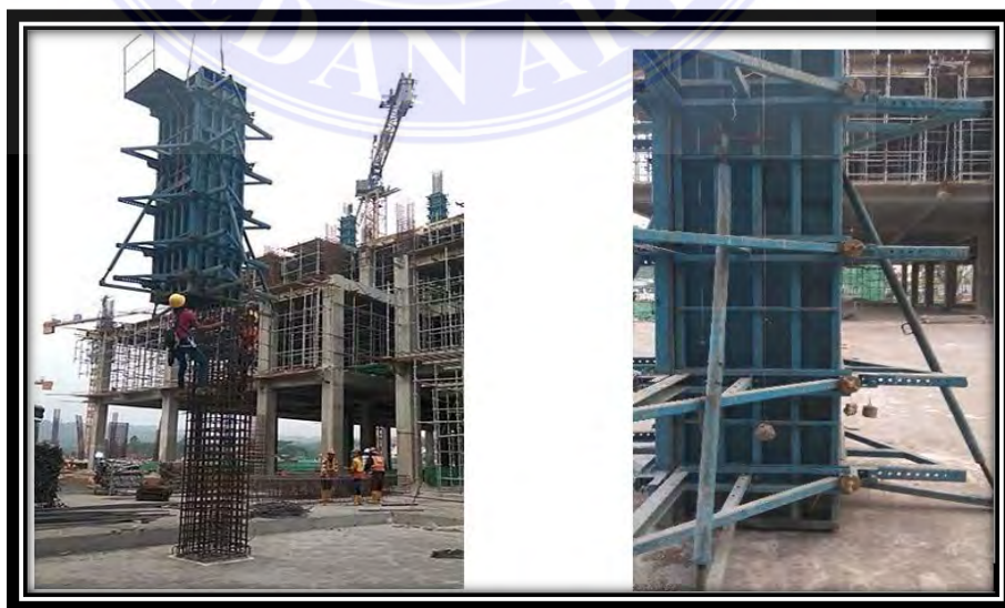
Gambar 4.5 Bekisting dengan Tower crane dan kolom siap di cor Sumber Dokumentasi Pribadi
