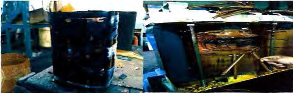
Gambar 4. 2 Kerusakan Gulungan Primer dan Sekunder
