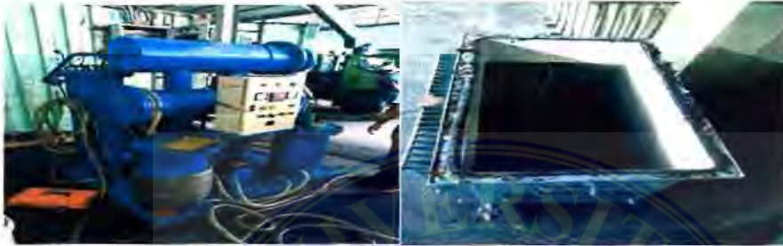
Gambar 4. 4 Mesin Filter Minyak Trafo dan Minyak Trafo Rusak
