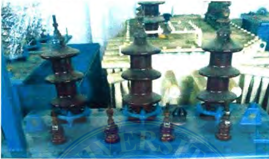
Gambar 3. 6 Bhusing pada Transformator
