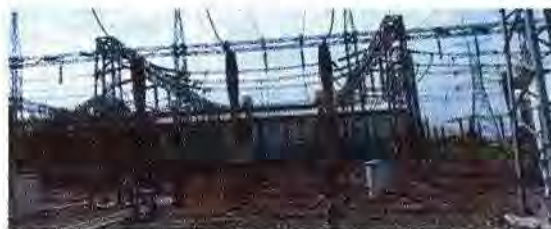
Gambar 2.24. Busbar (Rel Daya) Gardu Induk Tanjung Morawa
