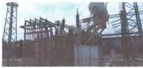
Gambar 2.3. Transformator Daya 3 (TD-3) di GI tanjung Morawa
