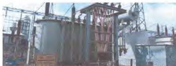
Gambar 2.2. Transformator Daya 2 (TD-2) di GI Tanjung Morawa Data – data pada transformator daya 2 (TD-2) pada GI Tanjung Morawa :
