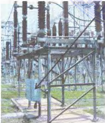
PMS 150 KV posisi masuk
