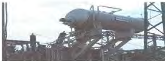
Gambar 2.7. Bentuk Tangki Konservator Pda Trafo Daya
