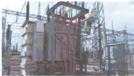
Gambar 2.1. Transformator Daya 1 (TD-1) di GI Tanjung Morawa
