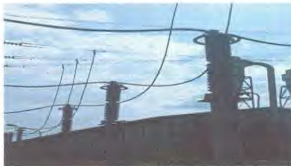
Gambar 2.12. Lighting Aresster GI Tanjung Morawa
