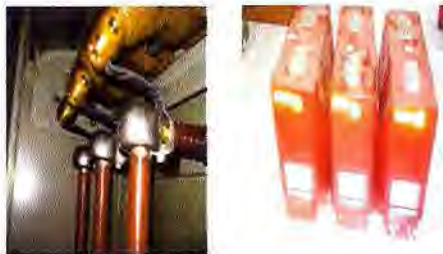
Gambar 2.4.2: Trafo tegangan dan Trafo arus
