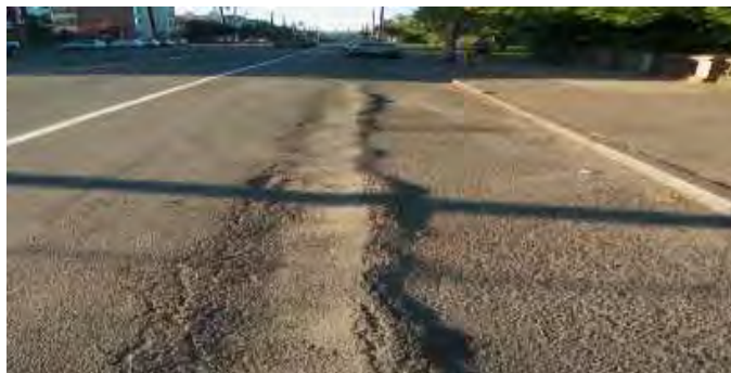
Gambar 2.16 Rutting Sumber : Dirjen Bina Marga 2017
