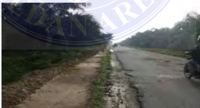
Gambar 2.8. Edge Cracking Sumber : Dirjen Bina Marga 2017
