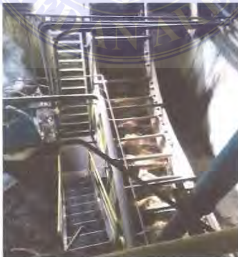
Gambar 3.2.4 Elevator Ampas Tebu Ke Boiler
