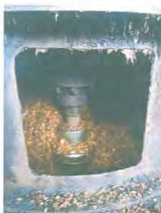
UNIVERSITAS MEDAN AREA Gambar 3. 14 Bagian dalam digester
