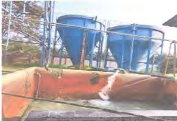
Gambar 3. 37 Clarifier Tank dan Bak Pengendapan
