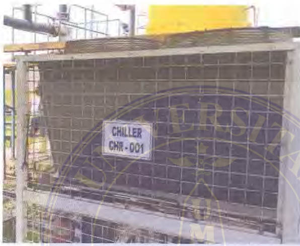
Gambar 3.16 Chiller Sumber : ( Dokumentasi kerja praktik )
