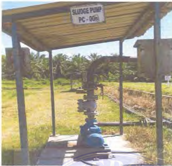
Gambar 3.8 Sludge Pump PC – 005 Sumber : (Dokumentasi kerja praktik )
