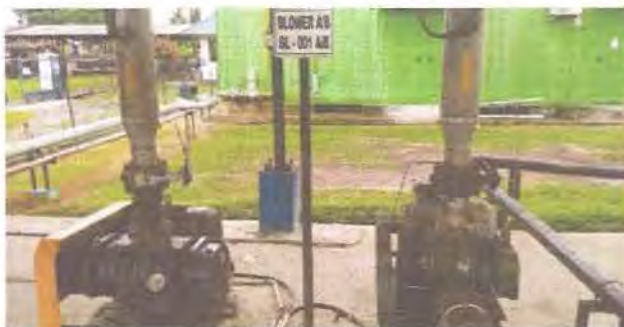
Gambar 3.18 Blower Sumber : ( Dokumentasi kerja praktik )
