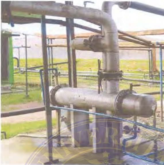
Gambar 3.17 Biogas Dryer Sumber : ( Dokumentasi kerja praktik )
