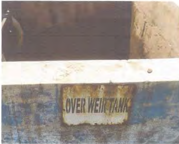
Gambar 3.10 Over Weir Tank Sumber : (Dokumentasi kerja praktik )
