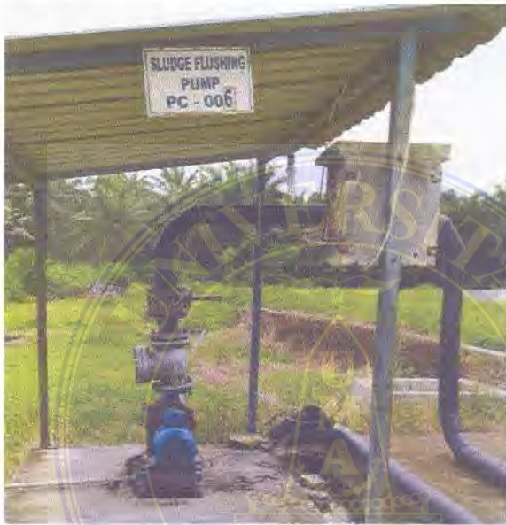
Gambar 3.7 Sludge Pump PC – 006 Sumber : (Dokumentasi kerja praktik )
