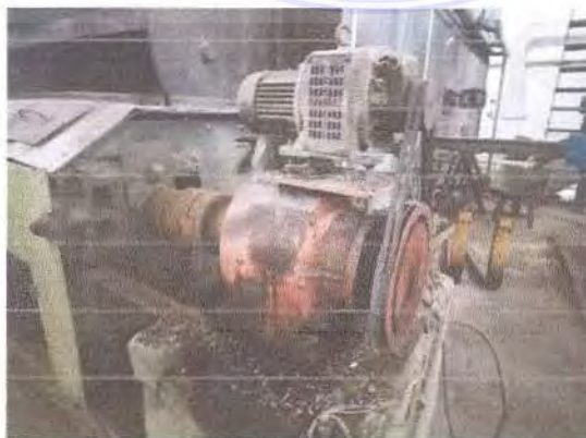
Gambar 3.12 Motor Penggerak Chain Grate
