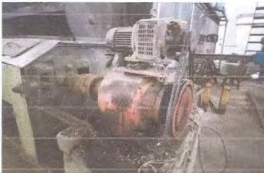
Gambar 3.12 Motor Penggerak Chain Grate
