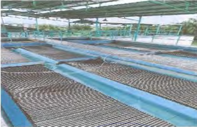
Gambar 3.5 Bak Penjernih ( Clarifier )
