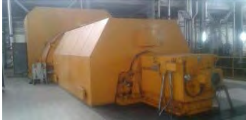
Gambar 2. 7 Generator PLTU Belawan Unit 3
