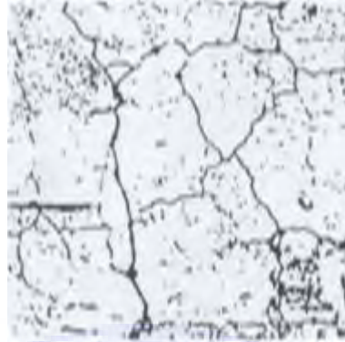
Gambar 2. 2. Retak akibat reaksi alkali– agregat
