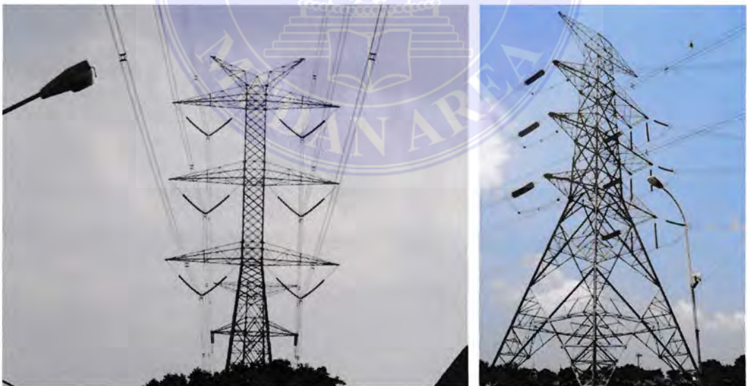
Gambar 2.6. Isolator yang terpasang pada tension tower type DD
