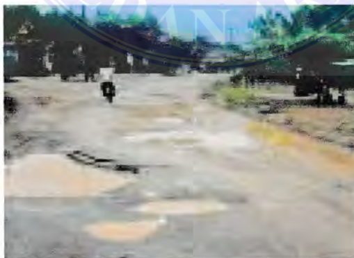
Gambar. 2.7 Permukaan jalan berlubang
