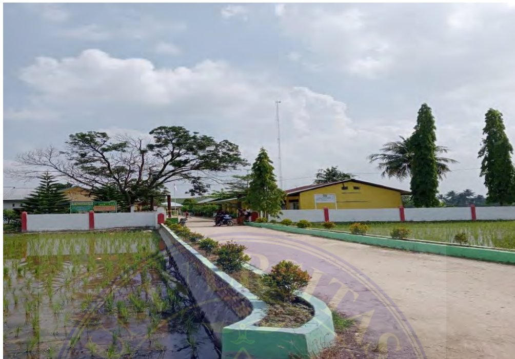
Gambar 11 Kondisi Jalan Menuju SD Negeri (Sumber: Dokumen pribadi 2023)
