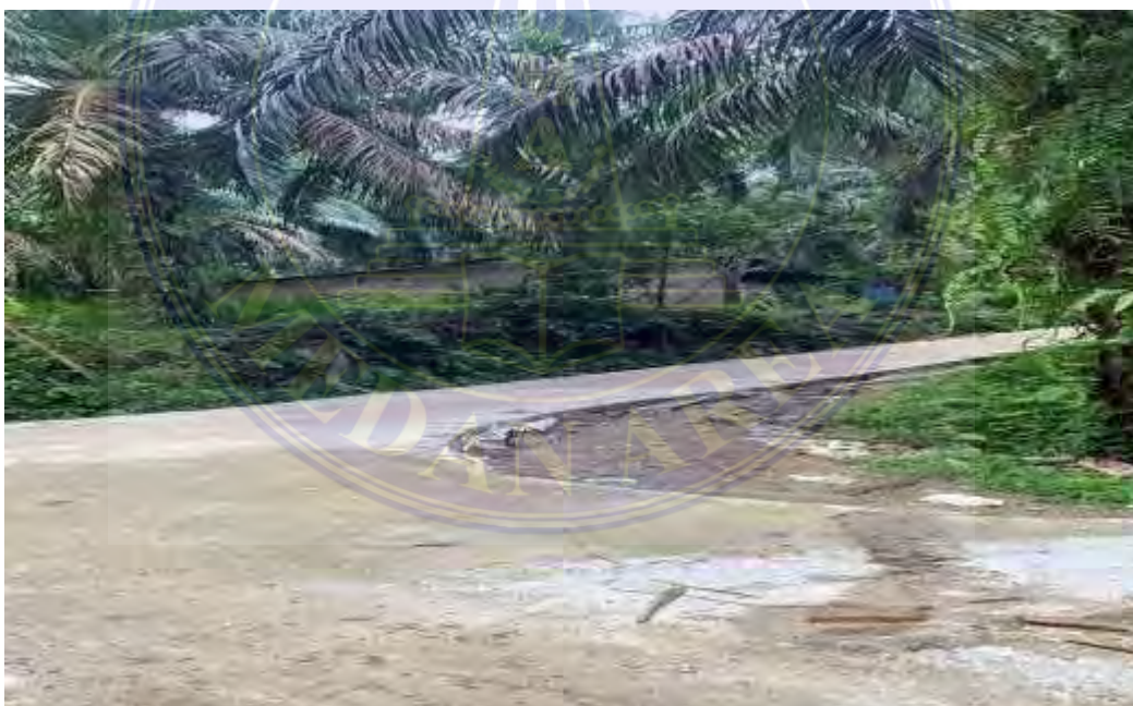
Dokumentasi Infrastruktur Jalan Yang sudah Selesai Di Perbaiki Di Desa Bangun Rejo
