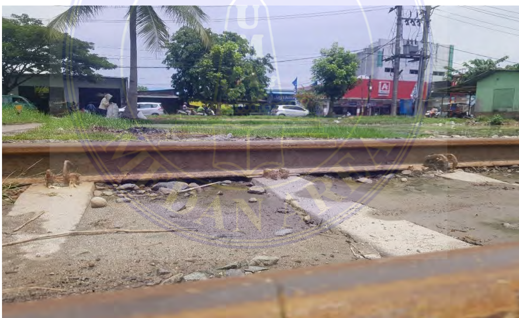
Gambar 4. Menunjukkan Elevasi Rel Sudah Setinggi Jalan Sumber : Data Lapangan
