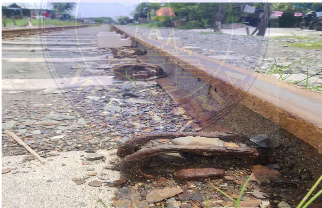
Gambar 6. Menunjukkan Dampak Trase Setelah Rutin Terendam Banjir Rob Sumber : Data Lapangan
