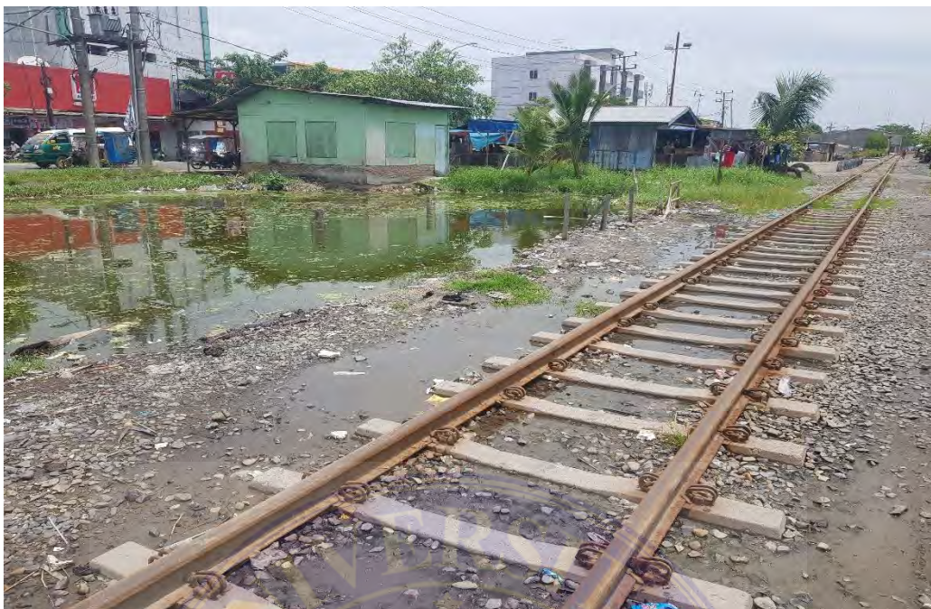
Gambar 5. Menunjukkan Trase Setelah Kondisi Genangan Sumber : Data Lapangan
