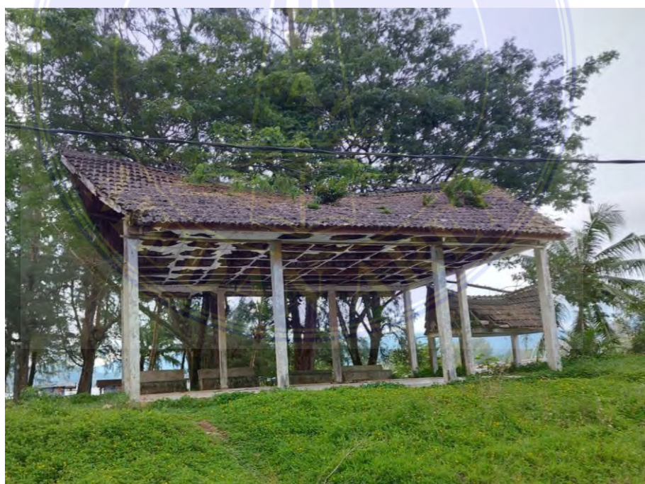
Gambar 5.10. Kondisi Gazebo Di Objek Wisata Pantai Kalangan
