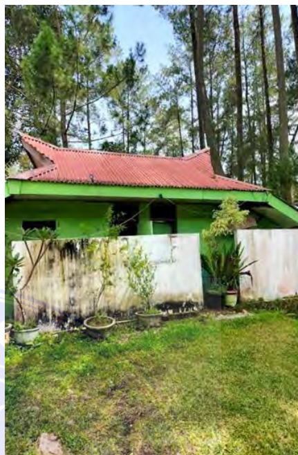
Kamar mandi umum yang rusak di TWI
