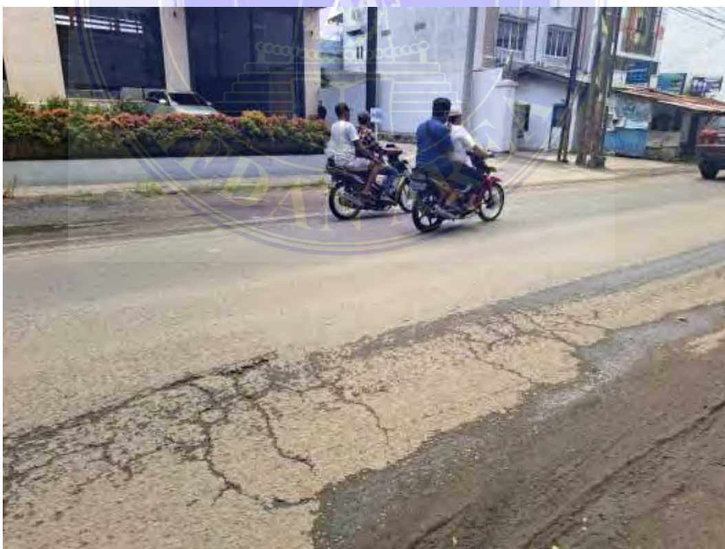
Jenis Kerusakan Retak Blok pada Jalan Cemara
