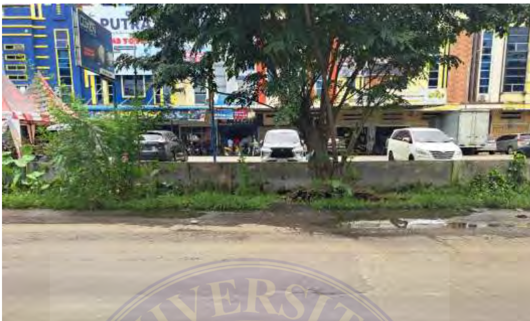
Jenis Kerusakan Tambalan dan Retak Pinggir pada Jalan Cemara
