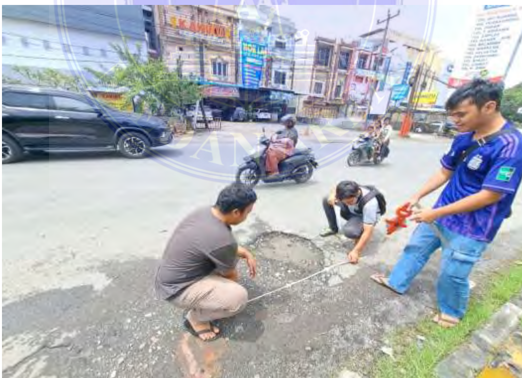
Pengukuran Dimensi Kerusakan Jalan Cemara
