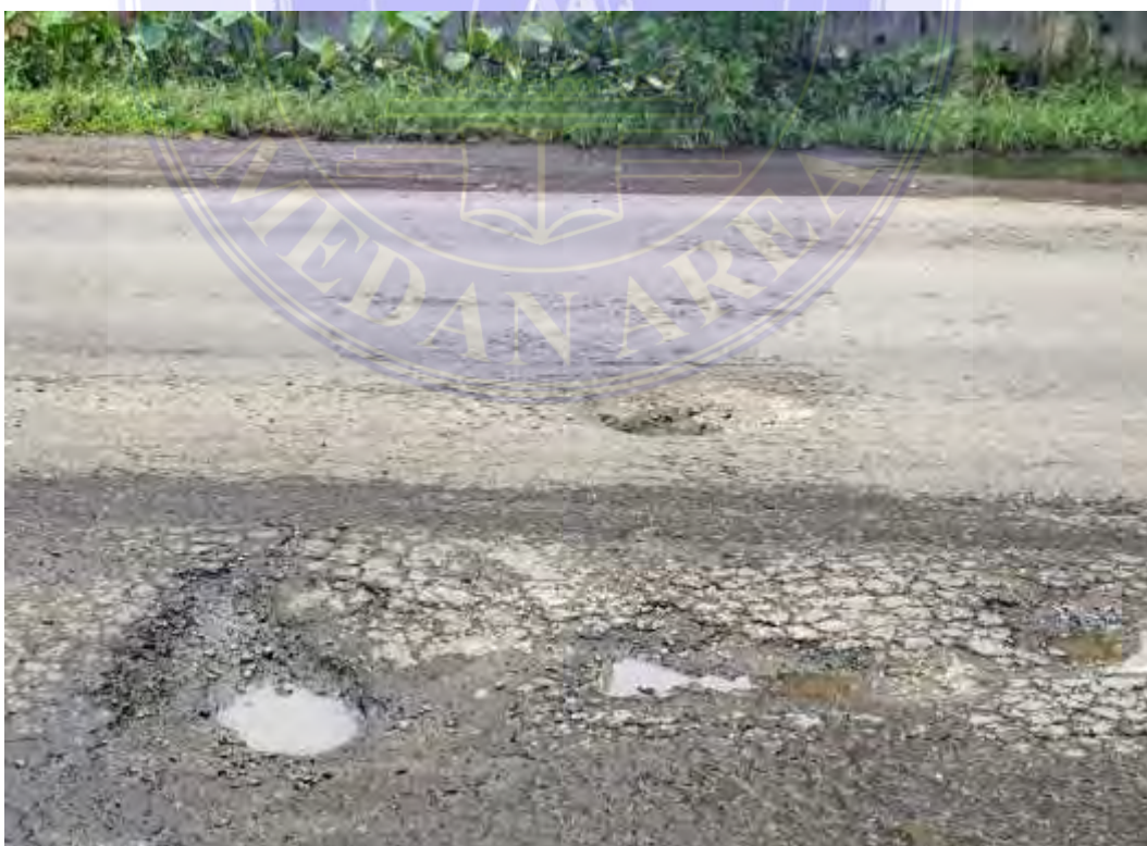
Jenis Kerusakan Lubang dan Retak Kulit Buaya pada Jalan Cemara
