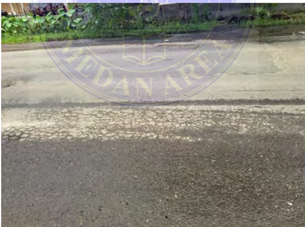
Jenis Kerusakan Tambalan dan Retak Kulit Buaya pada Jalan Cemara
