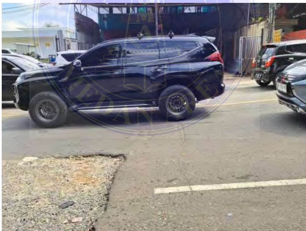
Jenis Kerusakan Patah Slip pada Jalan Cemara
