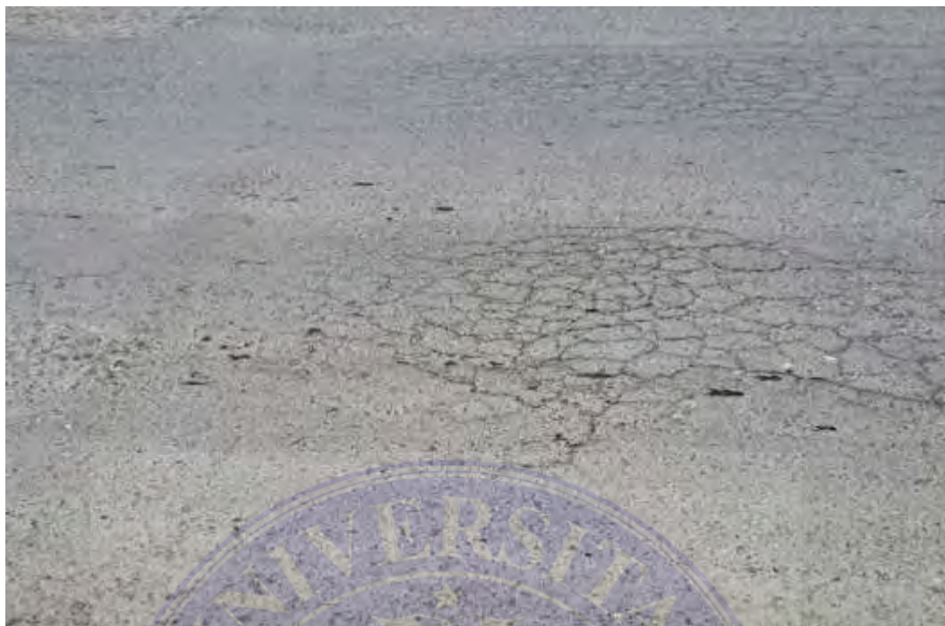
Jenis Kerusakan Retak Kulit Buaya pada Jalan Cemara
