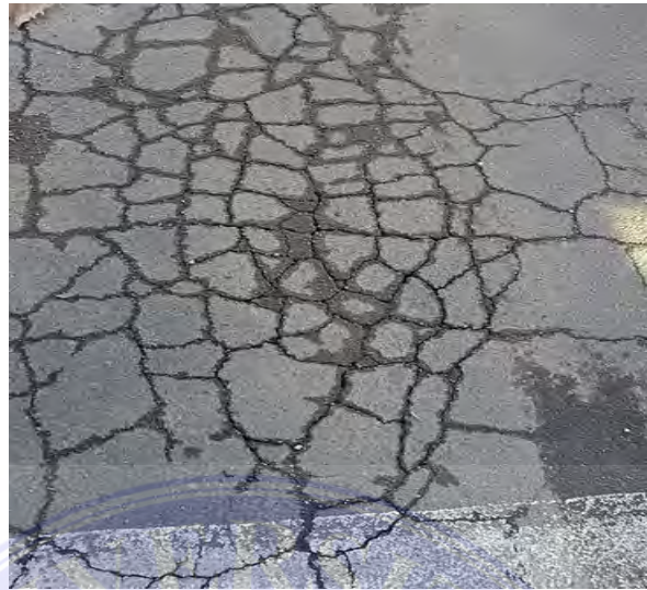
Gambar 23. Kerusakan retak Kulit buaya ( alligator cracks ) (Hardiyatmo, 2015)
