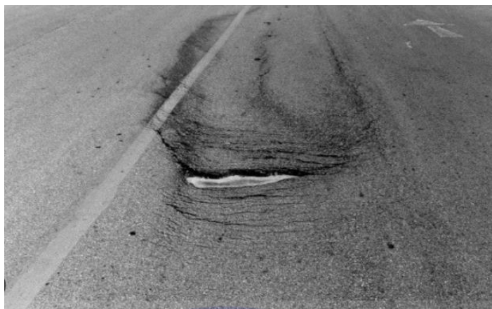
Gambar 27. Kerusakan retak slip atau retak berbentuk bulan sabit ( slippage cracks/crescent shape cracks ) (Hardiyatmo, 2015).
