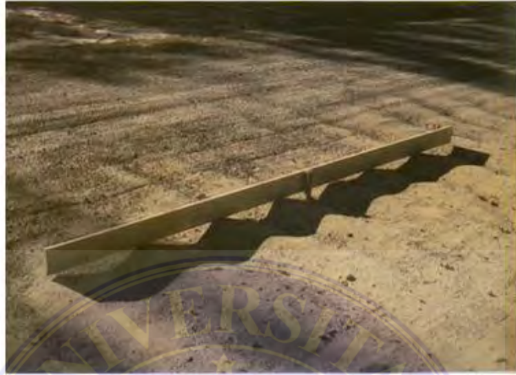
Gambar 11. Kerusakan bergelombang ( Corrugation ) (Hardiyatmo).
