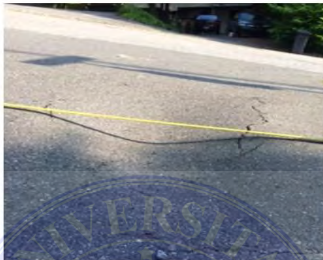
Gambar 7. Kerusakan amblas ( depression ) (Hadiyatmo,2015).
