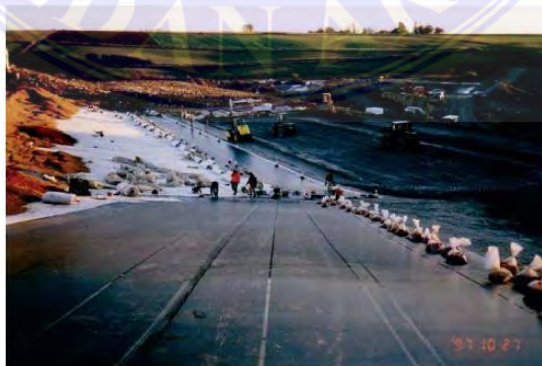
Gambar 13. Ilustrasi Pemasangan Geomembrane pada Timbunan (Müller, 2007)
