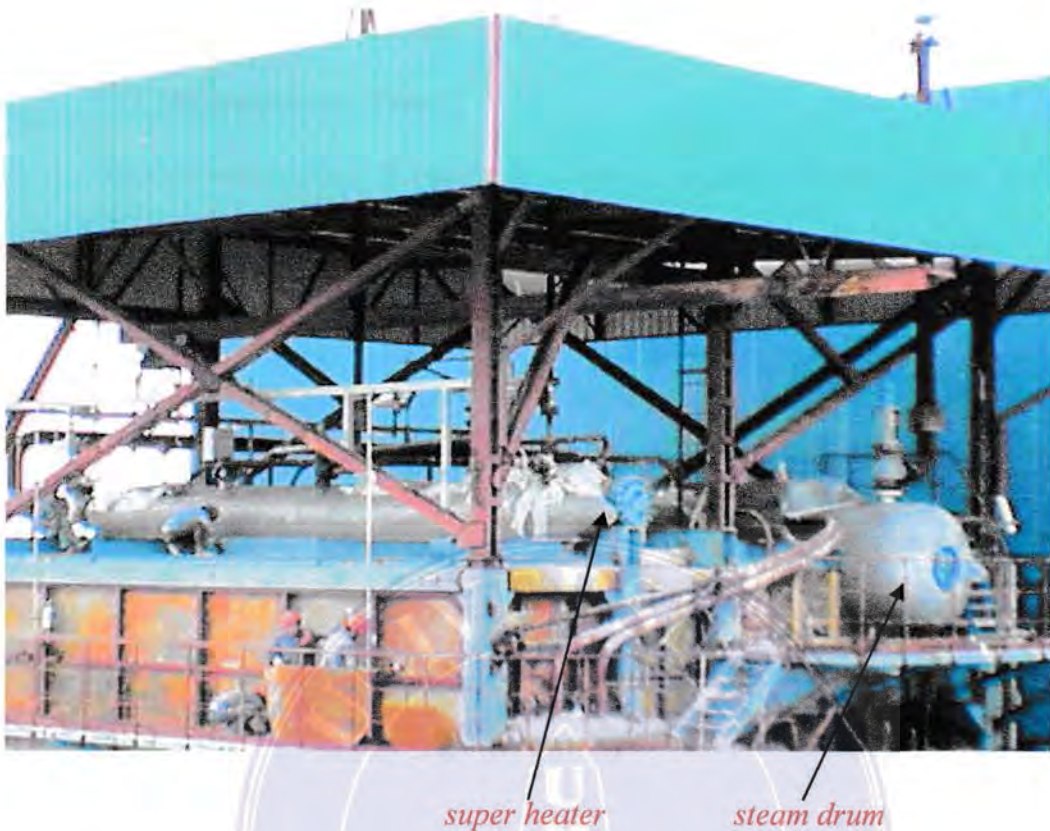
Gbr.2.17. Bagian Super Heater Pada Boiler Bagian Atas.
