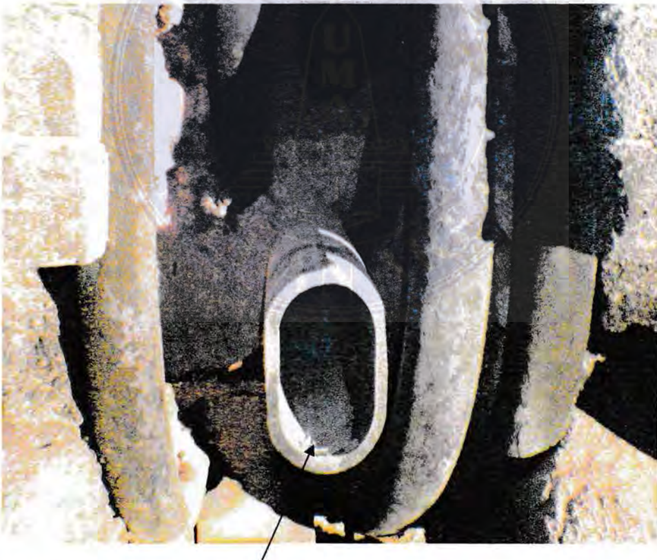
saluran udara secondary draft fan yang masuk ke ruang bakar
